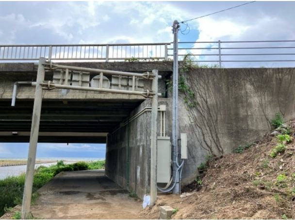
直流電源装置（柱上部に警告灯）
