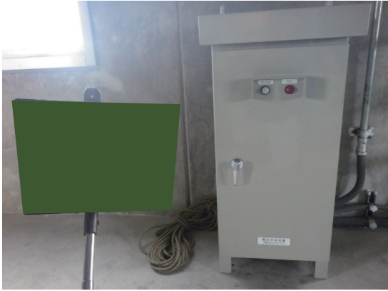
直流電源装置設置完了(機械室)
